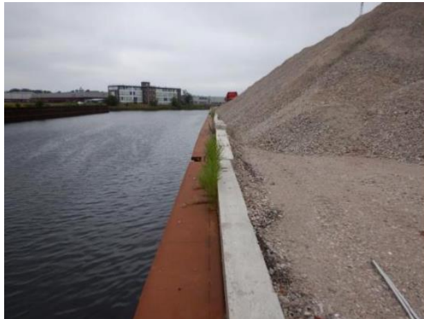
Figuur 4: Object 12C (Nieuwe industriehaven), grote bovenbelasting dicht bij de damwand.
